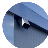
Évacuation eaux pluviales
