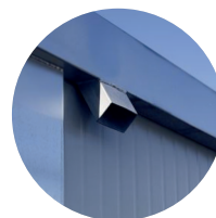
Évacuation eaux pluviales
